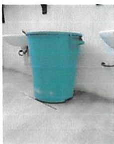
Foto 5: Accesorios para sanitarios y lavamanos
